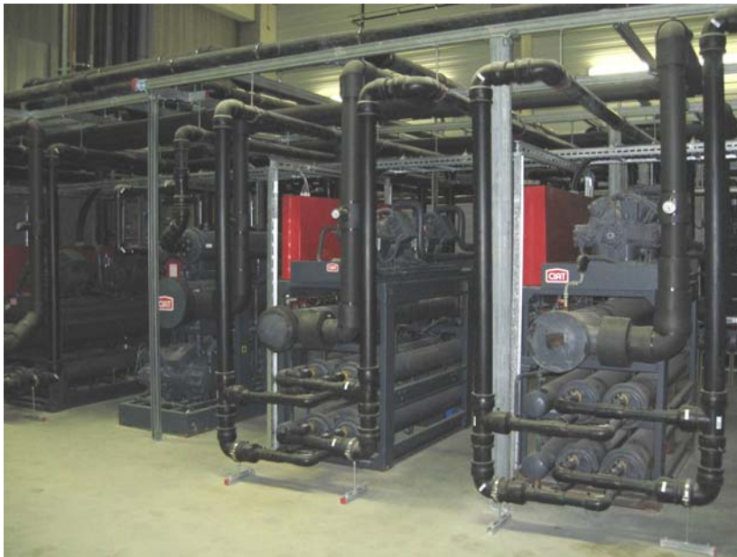
Körperschallgedämmte Aufstellung von Kältekompressoren und angeschlossenen Rohrleitungen in einem Technikraum (Kältezentrale)
